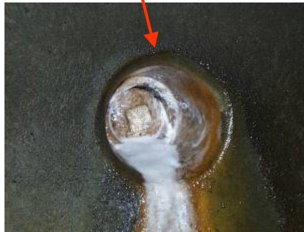
Vandgennemsivning ved grout plug
